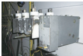
焼損したVCB
