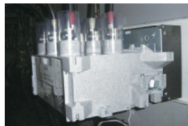
取替後のVCB
