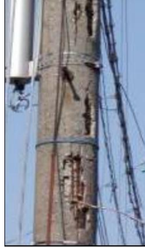
複数箇所の劣化
