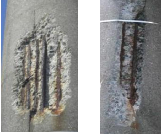
剥離・鉄筋露出
