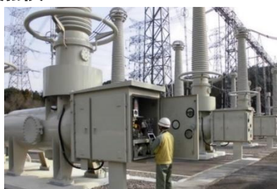
開閉器機構部を確認
