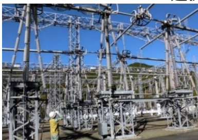
開閉器の投入状態を確認
