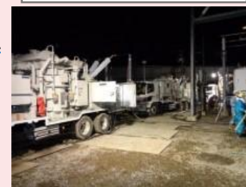
移動式変電所による停電対応
