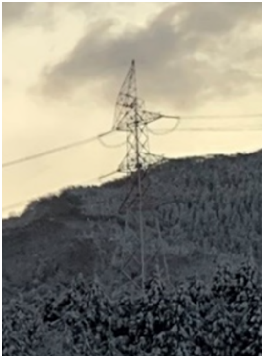
No50頂部損傷
