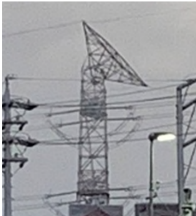
No51頂部損傷
